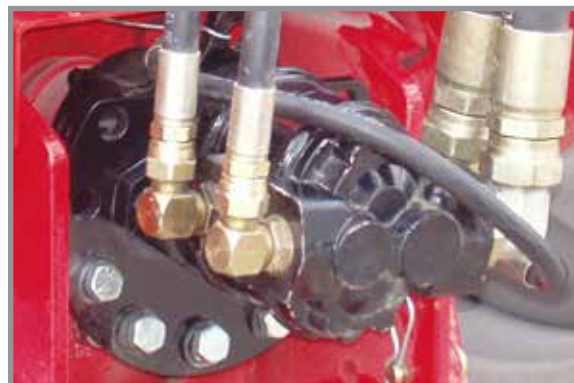
Установленный насос с приводом от ВОМ
